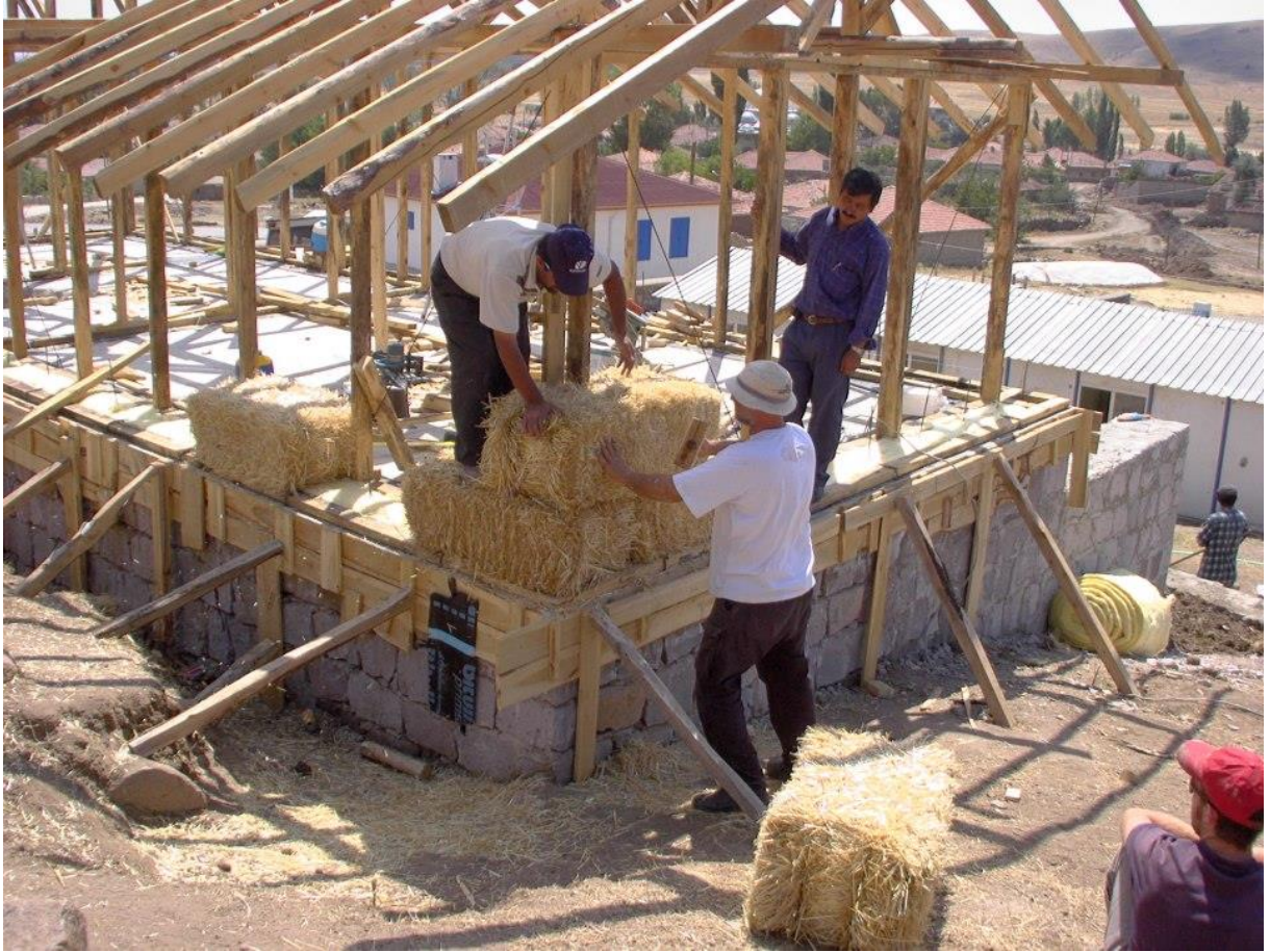
Şekil 2. Köydeki erkekler ŞAHDER binası olarak kullanılan, ahşap çatıklı, taş temeller üzerine oturan, saman balya duvarlı yapıyı inşa ediyorlar.
